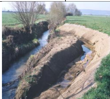
Aménagement de ruisseau et de collecteur pour ralentir le flux d'eau et dépolluer des eaux de drainage.
