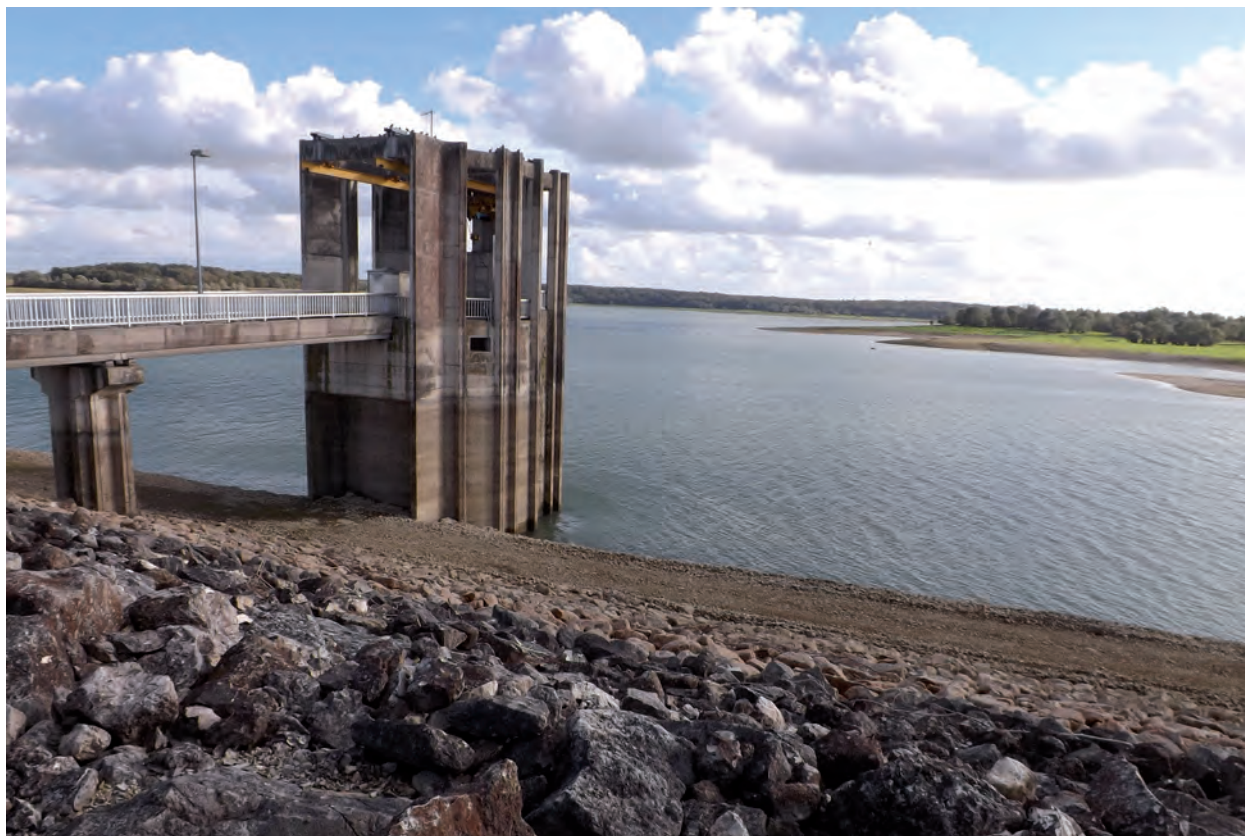
Tour des vannes de commande de la restitution du lac du Temple.
