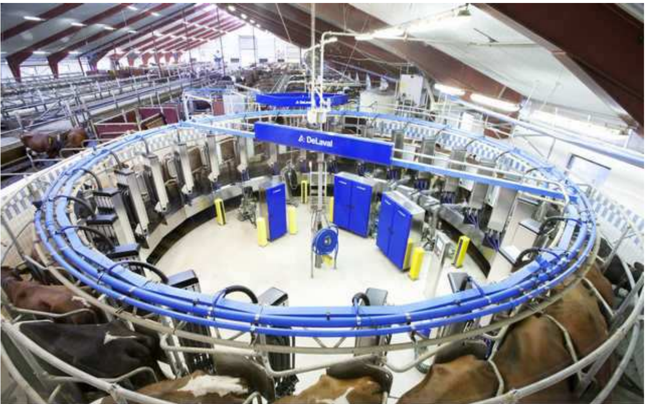
Robot sur salle de traite rotative Delaval ©Delaval
